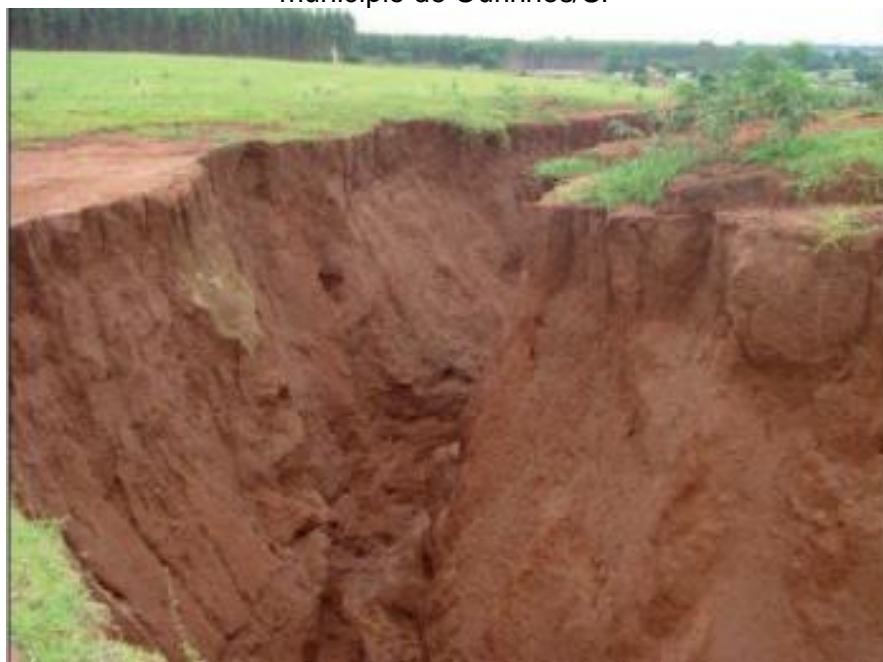
Figura 1 – Área degradada por erosão urbana, na Avenida Vitalina Marcusso no município de Ourinhos/SP
