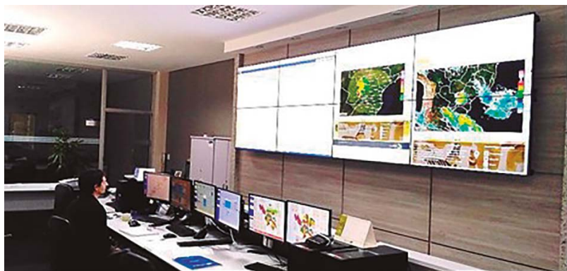
Figura 05: Controle Operacional de Abastecimento de Água de Londrina-PR.
