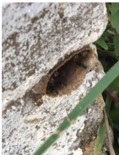
Figura 25: Iraí na caixa de energia
