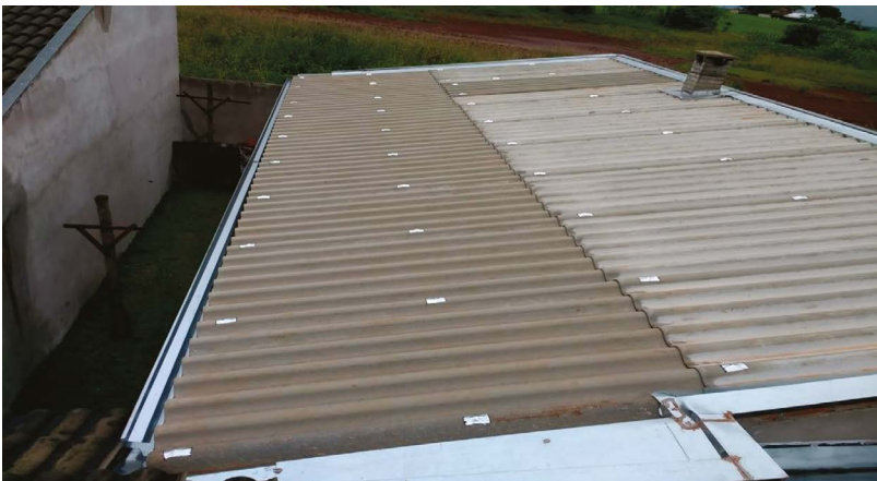
Figura 03: Área de captação pluvial.
