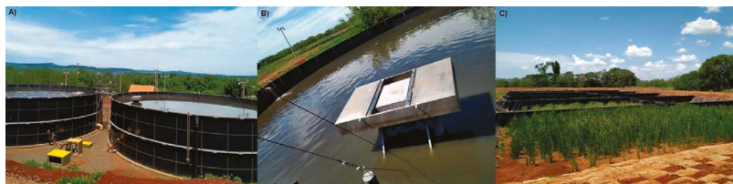
Figura 03: Reatores em Batelada (A) Vertedor Flutuante (B) e Can- teiros de mineralização de Lodo (C) da ETE de Santa Helena.
