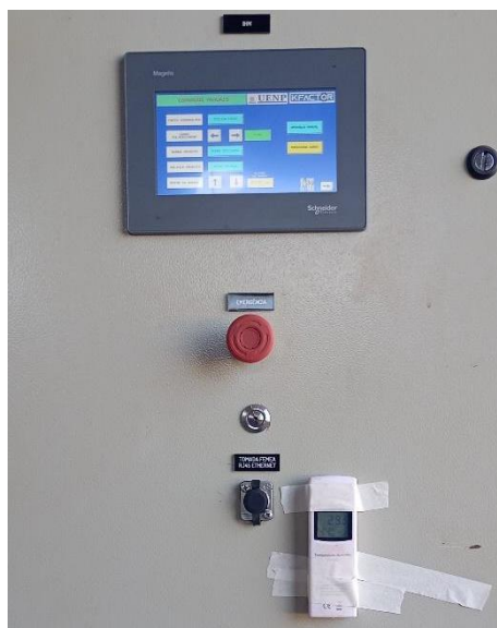
Figura 10. Painel de comando IHM com um medidor digital de temperatura e umidade. Fonte: Ferreira E.A.S (2025).
